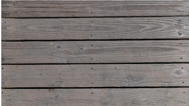
Vor der Reinigung (Einbau: Mai 2010)
