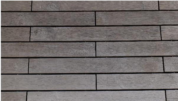
Vor der Reinigung (Einbau: Mai 2016)
