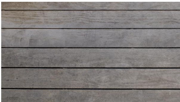
Vor der Reinigung (Einbau: Januar 2015)
