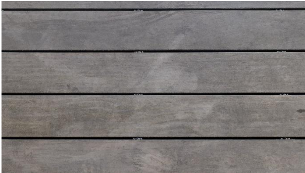
Vor der Reinigung (Einbau: März 2017)
