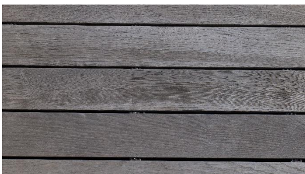
Vor der Reinigung (Einbau: Mai 2010)
