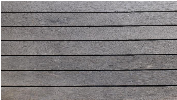
Vor der Reinigung (Einbau: März 2015)
