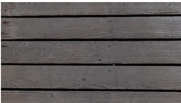
Vor der Reinigung (Einbau: März 2015)
