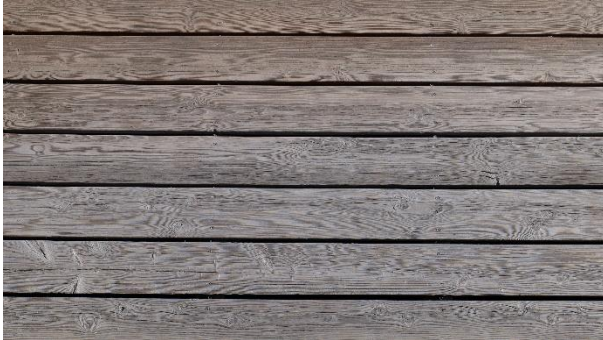
Vor der Reinigung (Einbau: Mai 2010)
