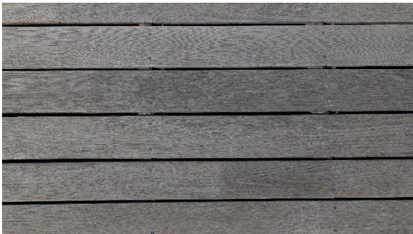
Vor der Reinigung (Einbau: Mai 2010)
