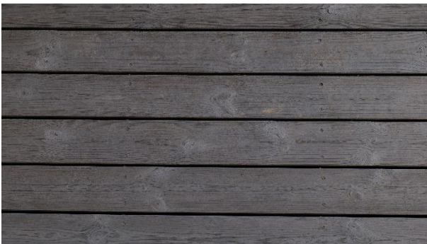
Vor der Reinigung (Einbau: Mai 2020)
