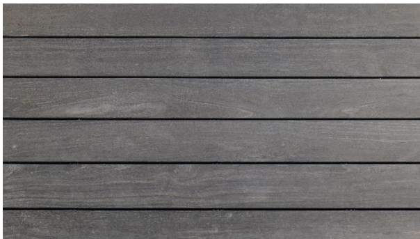
Vor der Reinigung (Einbau: Mai 2020)
