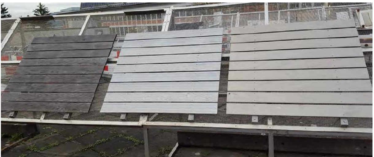
Abbildung 2, Prüfkörper nach rund zwei Jahren (November 2019)
